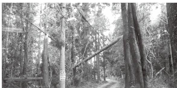
昨年の台風15号による倒木により損傷した電線（山之郷地先）
