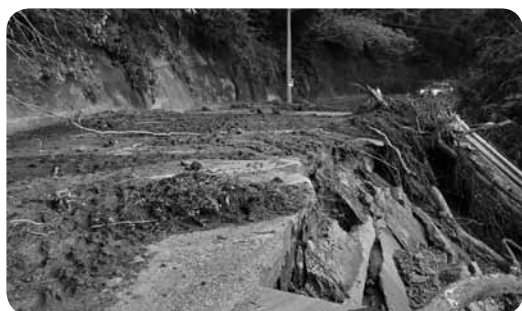
道路が崩落した県道長柄大多喜線針ヶ谷坂
